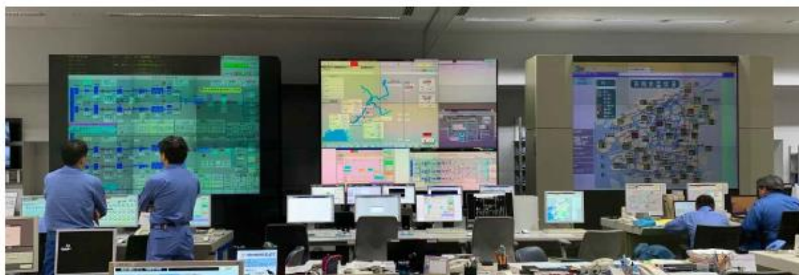
Phase2における総合水運用センターの様子
